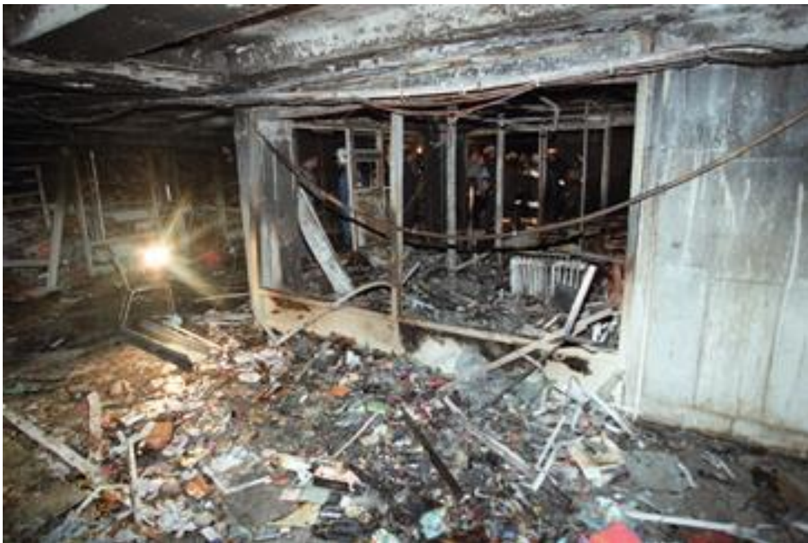
Рис. 4. Последствия взрыва в подземном переходе из метро на Пушкинской площади в Москве 8 августа 2000 г. (Фото: Антон Денисов / ТАСС)
