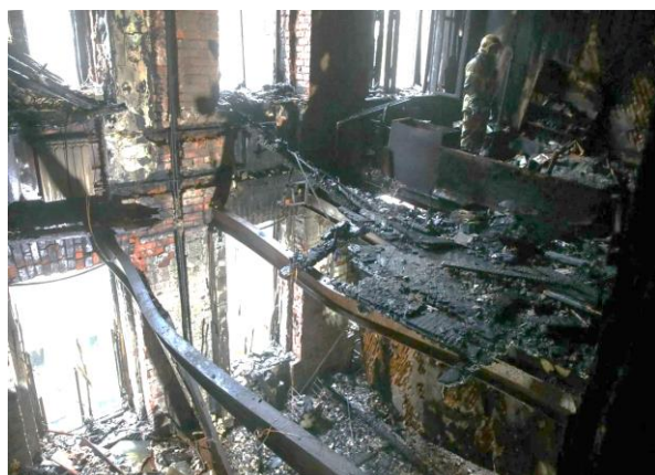
Рис. 2. Потеря несущей способности стальных конструкций при пожаре на улице Никитской в Москве
