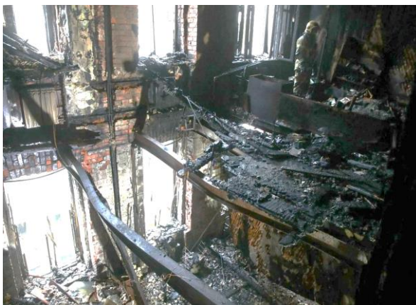
Рис. 2. Потеря несущей способности стальных конструкций при пожаре на улице Никитской в Москве
