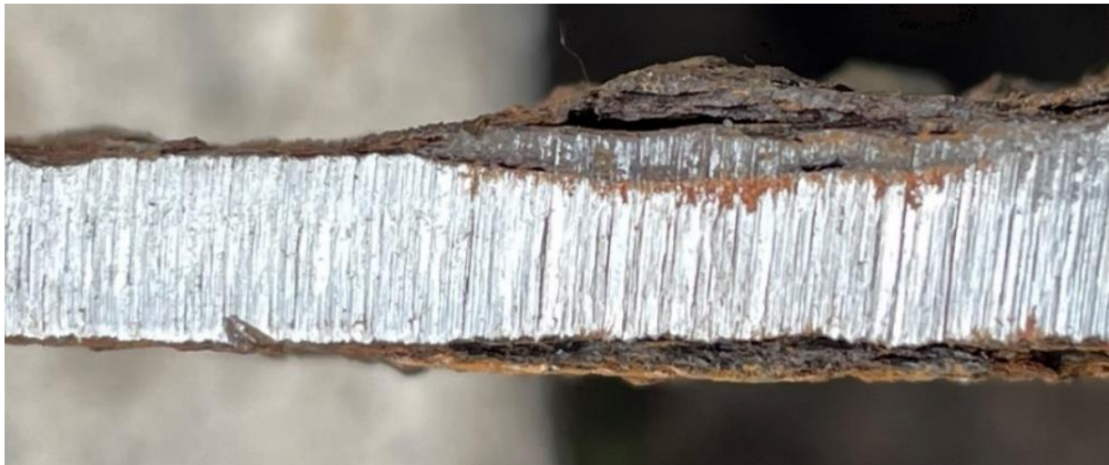
Рис. 10. Характерный участок со следами значительной коррозии стального образца (срок эксплуатации с 1936 года)
