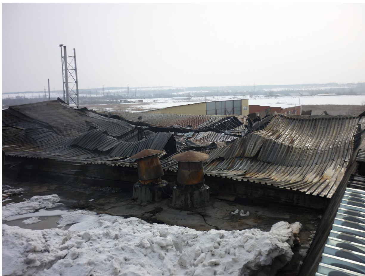
Рисунок 2. Нависание профилированных стальных конструкций над производственно-складскими помещениями после пожара
