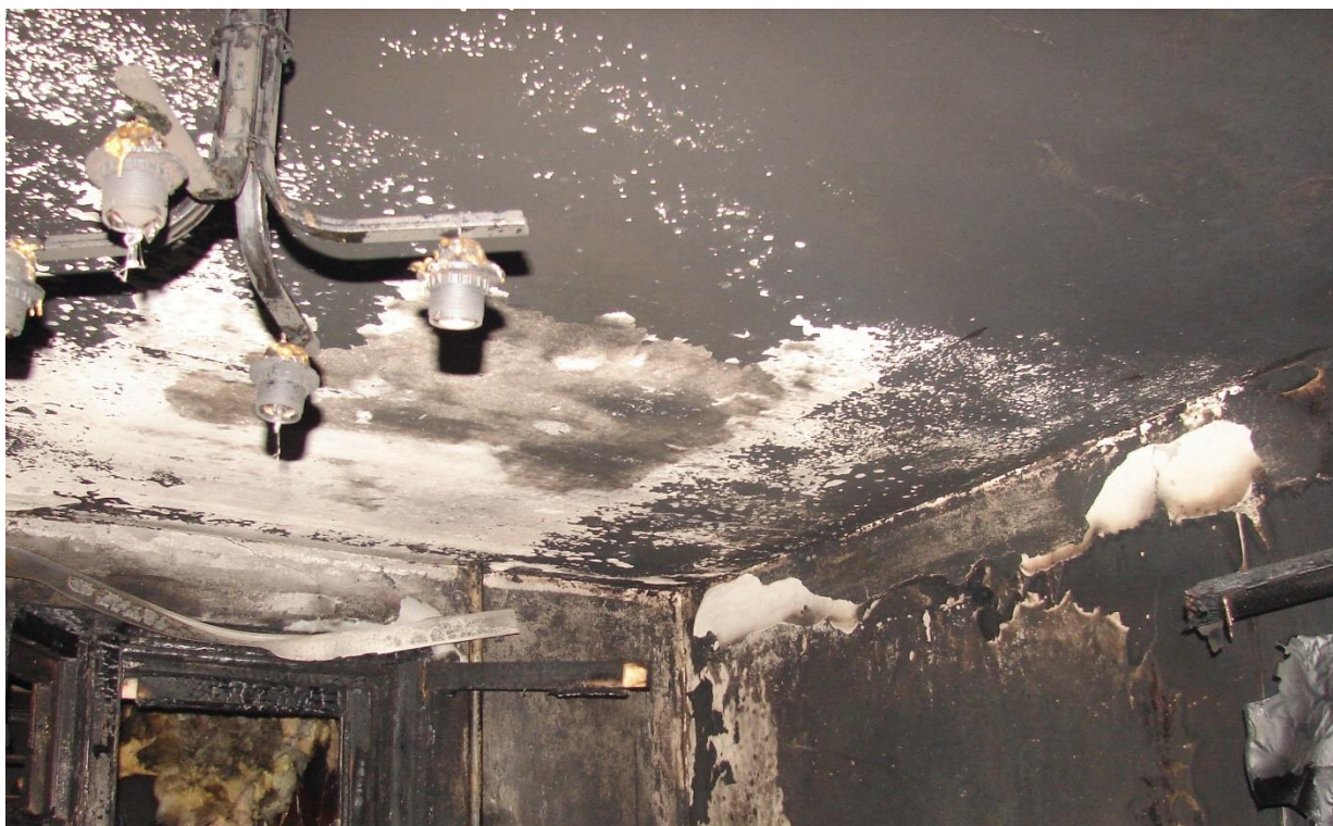
Рисунок 3. Железобетонные конструкции после пожара. Участки выгорания копоти свидетельствуют о нагреве поверхности конструкции выше 600 °С
