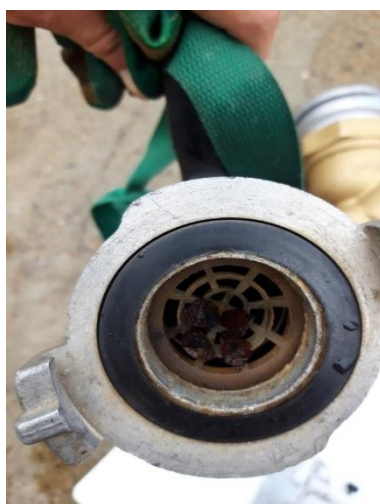
Рисунок 9. Твердые частицы на успокоителе пожарного ствола
