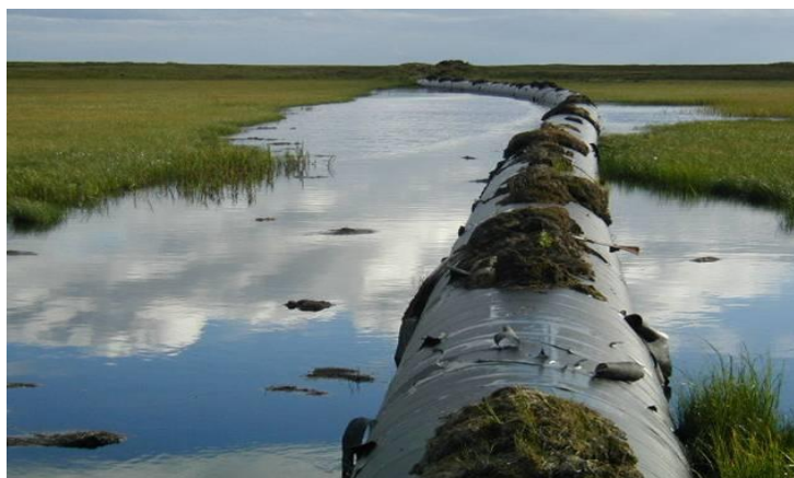
Рисунок 2. Трубопроводы в криолитозоне
