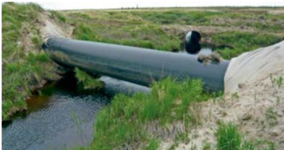
Рисунок 5. Образование провала и оголение подземного участка трубопровода
