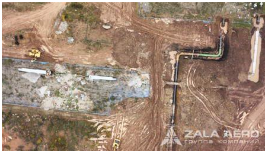
Рисунок 3. Фото мониторинга газопровода с помощью БЛА
