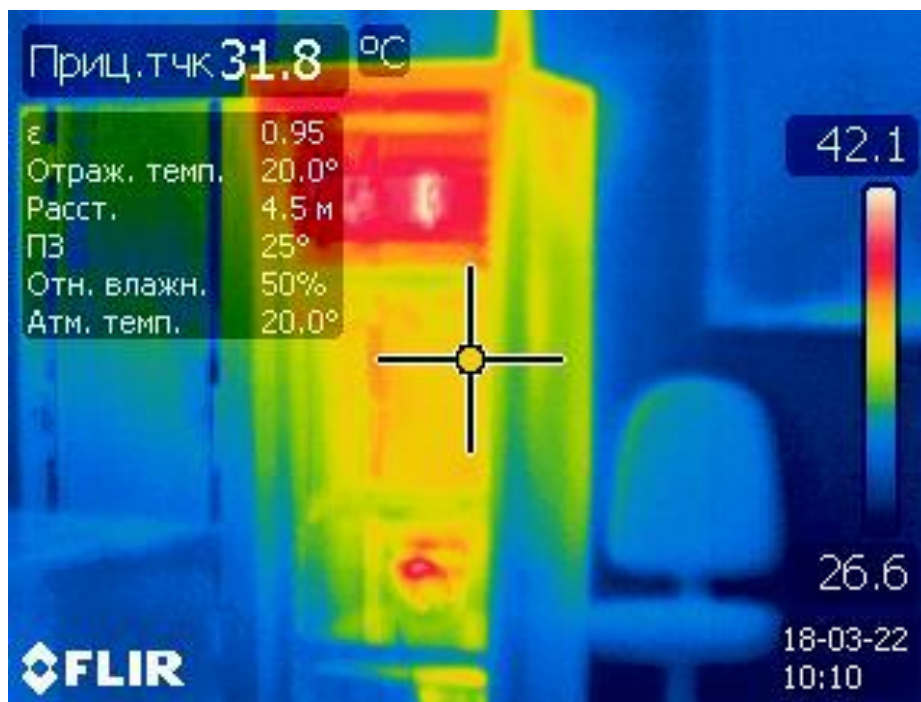
Рисунок 1. Телекоммуникационная стойка с радиоэлектронным оборудованием
