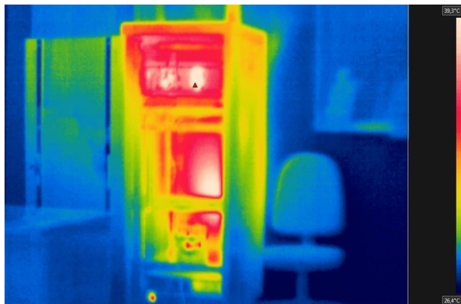
Рисунок 2. Температурное состояние телекоммуникационной стойки с большим потреблением мощности
