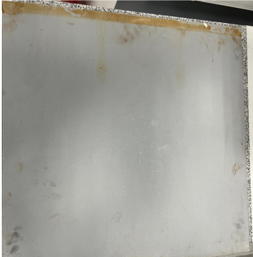
Рис. 4. Состояние системы покрытия после 224 циклов старения
